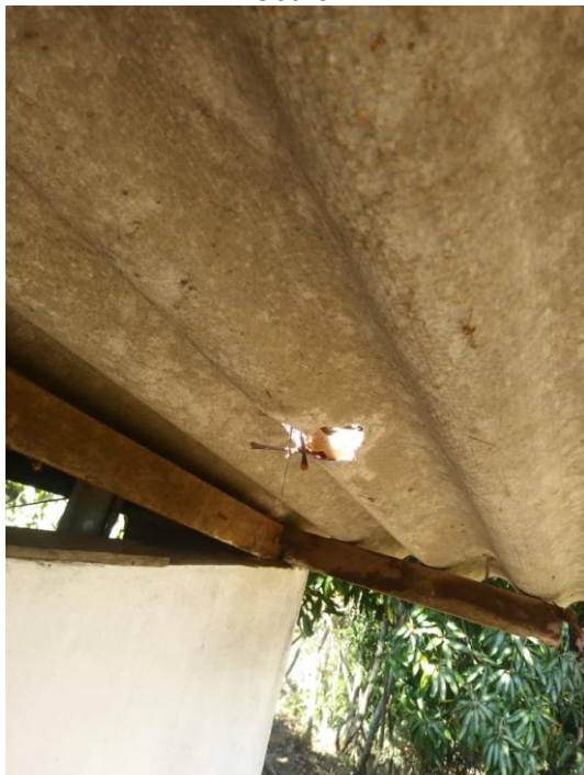
Figura 1: Telhado danificado pelos galhos do Cedro.
